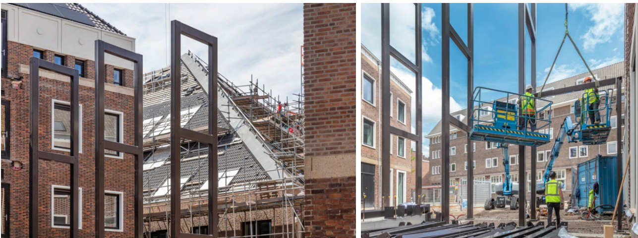
Op 10 juli 2024 is er gestart met het plaatsen van de staalconstructie voor de passerelle tussen gebouwen Jaune en Vert
